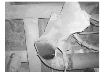
爆裂した厚さ11ミリの配管
