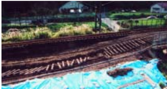
線路陥没(大広田)
