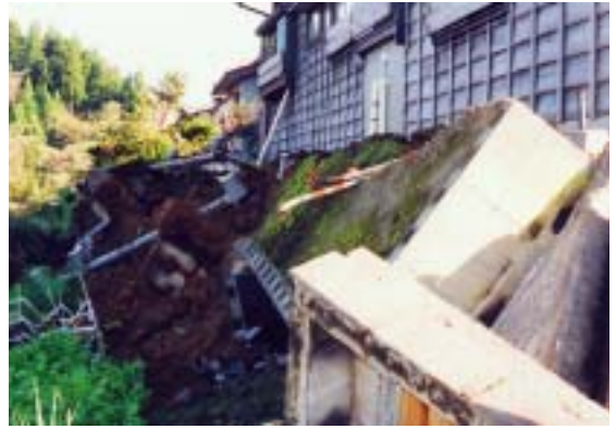
住宅裏の崖崩壊(四日町)
