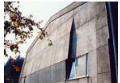
11月4日の余震でコミュニティ体育館外壁も崩落寸前
