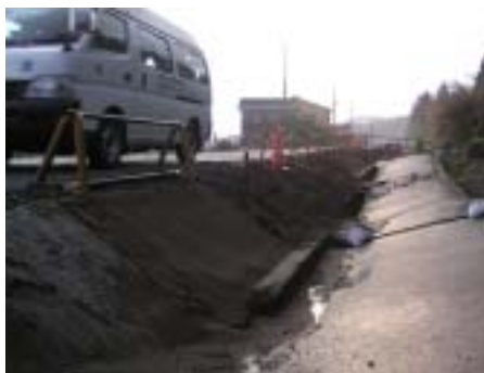
地震発生直後に陥没した県道(旧広田)
