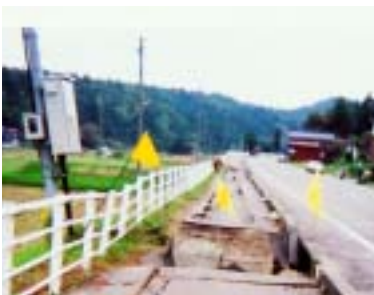
下水マンホールと陥没した歩道(深沢)
