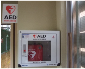
渡り廊下に設置された AED
